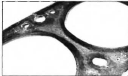
Рис. 4.41. Негерметичность прокладки головки между цилиндрами (видны черные следы копоти на окантовке в местах прорыва газов)
